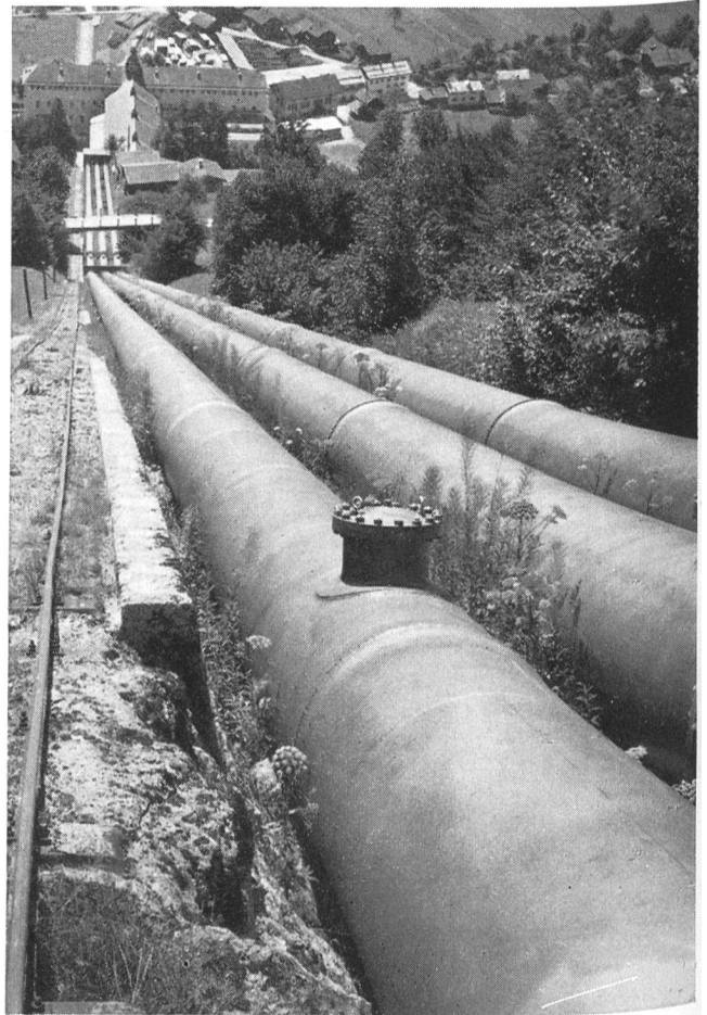
AG. Bündner Kraftwerke Kraftwerk Küblis, Druckrohrleitungen
