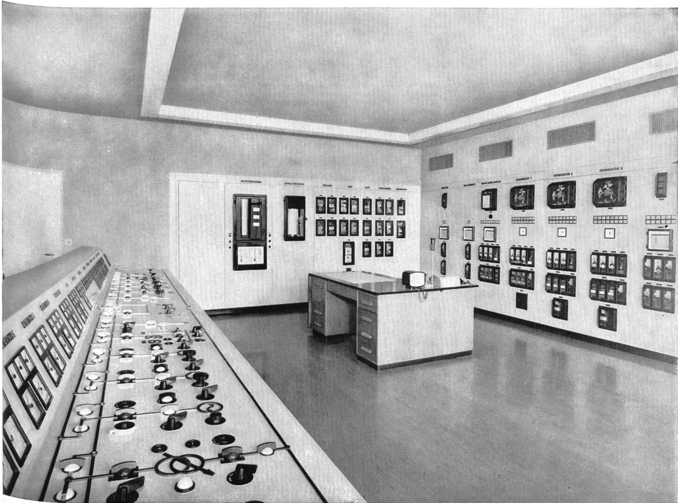
Kommandoraum Kraftwerk Rüchlig
