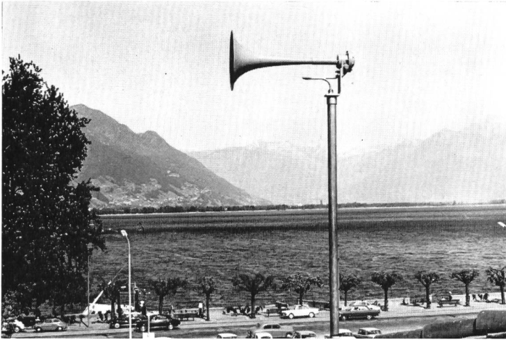
Eine der vielen in der Schweiz bereits montierten Ericsson-Tyfon®-Wasser- alarm-Sirenen (Verzasca S. A., Locarno)
