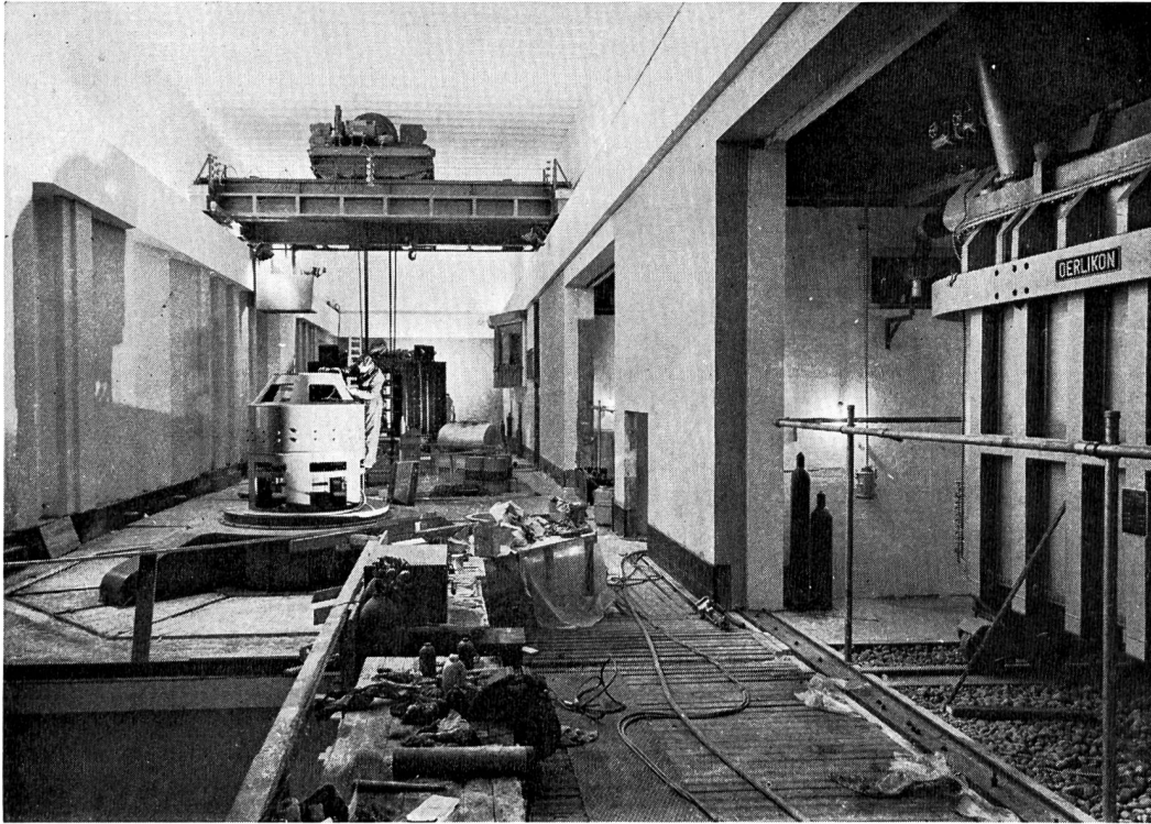
Bild 12 Maschinensaal des Usta-Kraftwerks im zentralen Südnorwegen.
