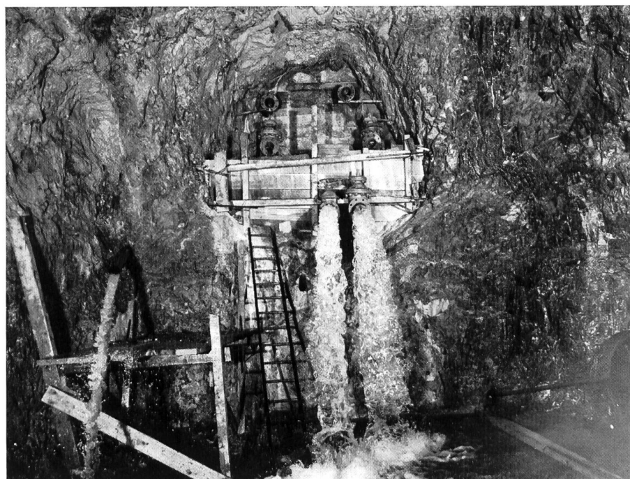
Bild 64 Druckstollen Sampuoir, Stollenmeter 307 der Umfahrung, steigend. Abschluss des eingebrochenen Firststollens mit einer Betonmuer (Wassereintritte ca. 80 l/s) Aufnahme vom 13. Mai 1966.
