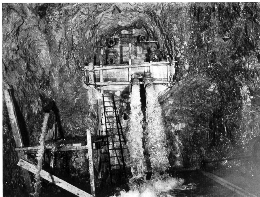
Bild 64 Druckstollen Sampuoir, Stollenmeter 307 der Umfahrung, steigend. Abschluss des eingebrochenen Firststollens mit einer Betonmauer (Wassereintritte ca. 80 l/s) Aufnahme vom 13. Mai 1966.
