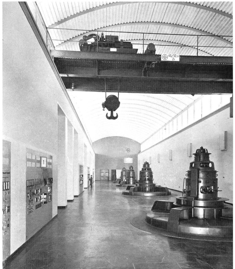
Bild 1 Maschinensaal Zentrale Verbano
