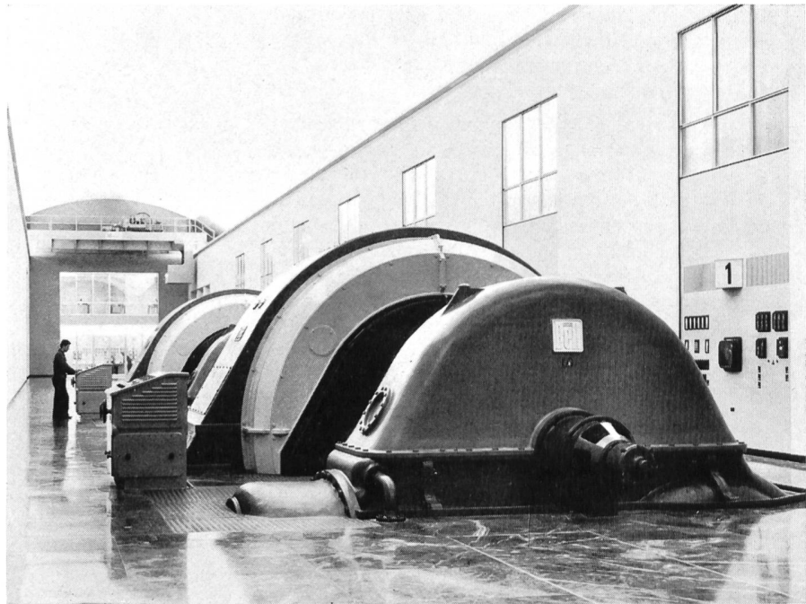
Bild 3 Maschinensaal Zentrale Cavergho
