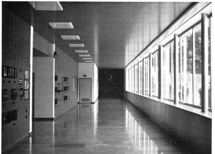
Bild 2 Blick in den Innenraum der Zentrale Schaffhausen.
