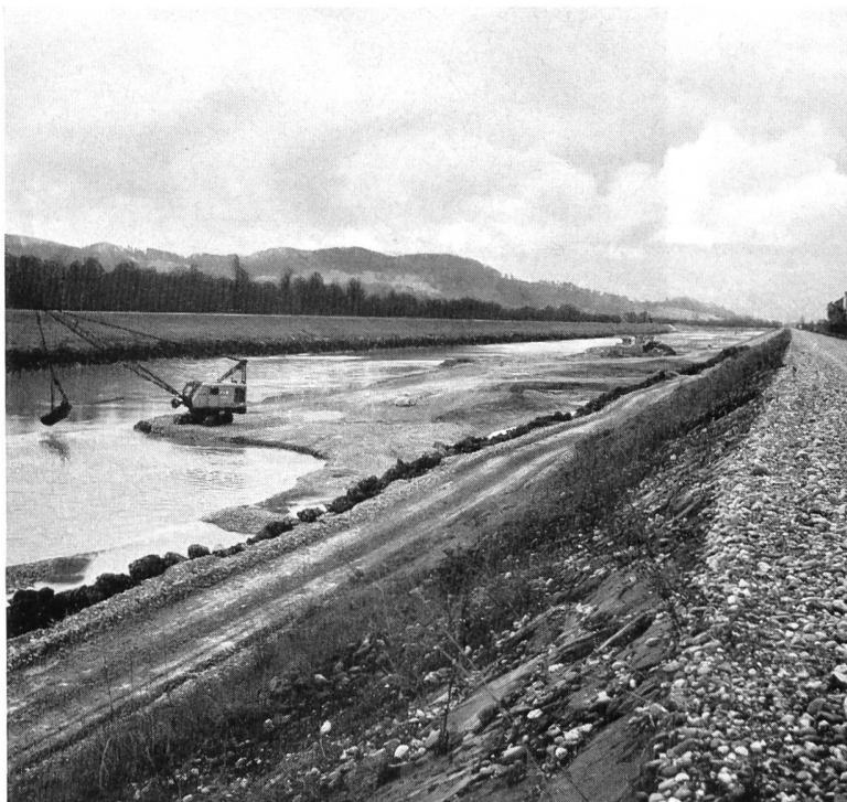
Bild 30 Ausbeutung einer Kiesbank in der st. gallisch-liechtensteinischen Rheinstrecke; im Hintergrund das Werk Salez der Rheinkies AG. Der wasserseitige Fuss des Rheindammes ist gegen Unterspülung geschützt durch einen 5 m breiten Blockwurf, welcher durch ständige Nachschüttung der sich absenkenden Sohle angepasst wird. Ueber dem Blockwurf ist eine dem Unterhalt dienende Fahrstrasse angelegt; die Böschung des Hochdammes ist mit groben Steinen gepflästert.
