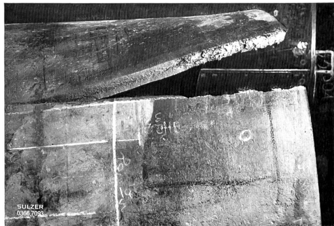
Bild 7 Beim Abpressversuch entstandener vorzeitiger Rohrbruch (Mischbruch), ausgehend von örtlich zerstörtem Material infolge Wassergasschweissung.
