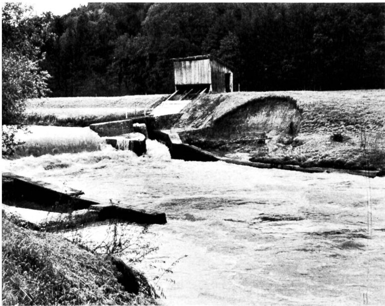
Bild 3 Murg. Uferschäden beim Wehr Aumühle.
