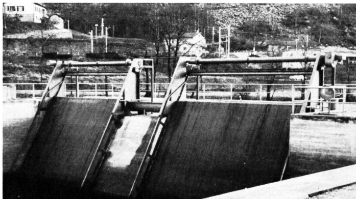
Rechenreinigungsanlage Biaschina der AET
