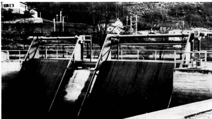
Rechenreinigungsanlage Biaschina der AET
