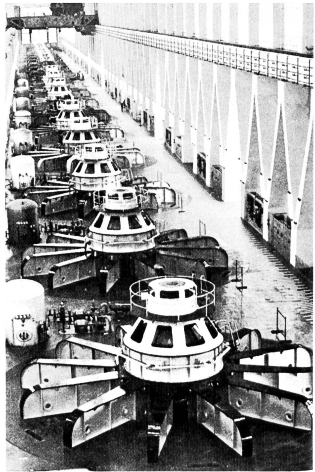
Bild 81 Innenansicht der riesiglangen Zentrale Bratsk mit 20 Maschineneinheiten von je 250 MW (aus BWK 1969 Nr. 2 S. 77).
