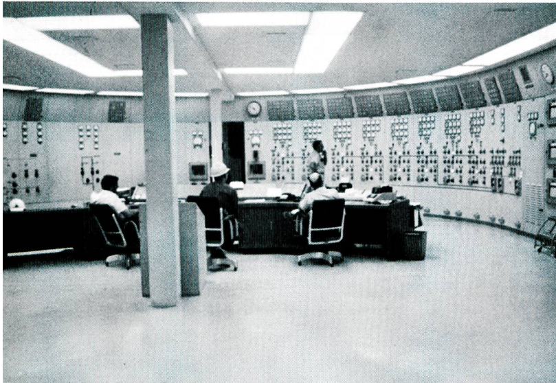
Bild 38 Blick in die Kommandozentrale Glen Canyon.
