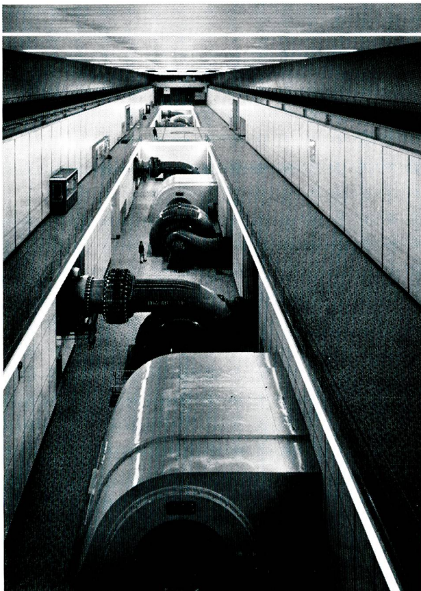
Bild 14 Innenansicht des Kavernenkraftwerks Säckingen
