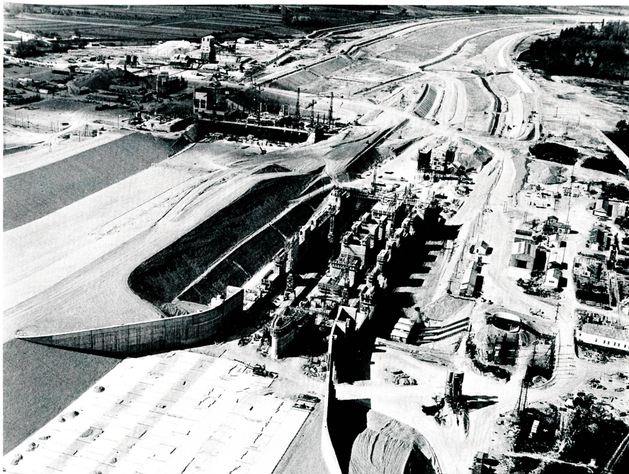
Figure 9 Vue aérienne des installations construites de 1959 à 1963 pour les écluses de navigation (au centre) et l'usine de Rhinau (en haut à gauche)
