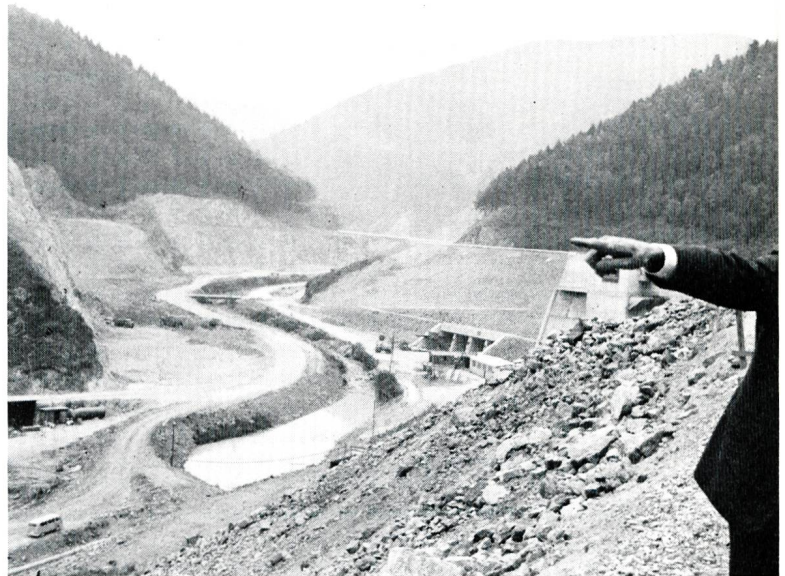
Bild 3 Blick in die Baugrube des Wehrbeckens der Hornbergstufe für die Pumpspeicheranlage des Hotzenwaldwerks der Schluchseewerk AG.
