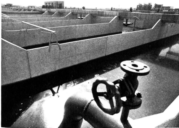
Bild 5 Belebtschlammbecken. Die Kläranlage umfasst fünf Belebtschlammbecken; jedes einzelne ist so gross wie zwei Fussballfelder.
