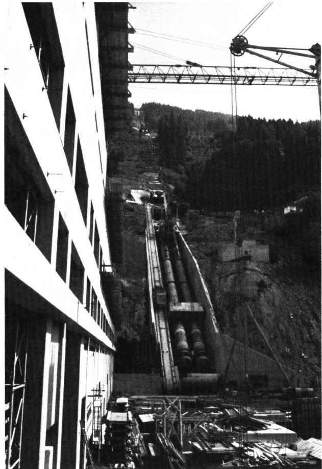
Bild 3 Druckleitung und Zentrale Rottau der Hauptstufe der Kraftwerkgruppe Malta in Kärnten.
