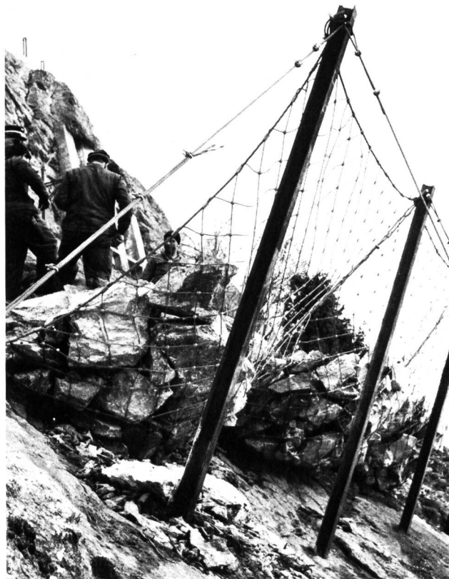
Bild 1 Steinschlag-Verbauung zum Schutz der BLS Lötschberg-Südrampe. Rechtecknetze 2,7 x 3,0 m, Maschenweite 20 cm. Belastung gemäss Bild rund 8 m 3 Fels.
