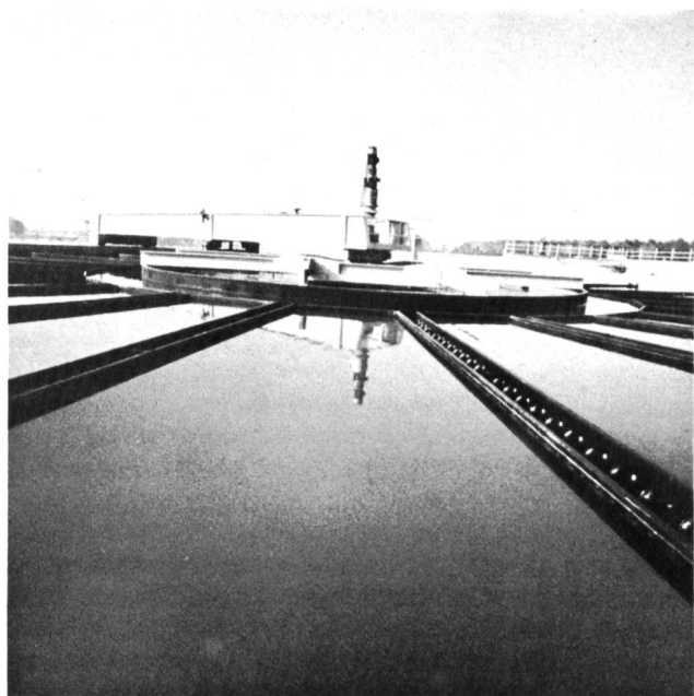
Bild 9. Flockungsreaktor der neuen Anlage. Décanteur flocculateur de la nouvelle station de traitement.
