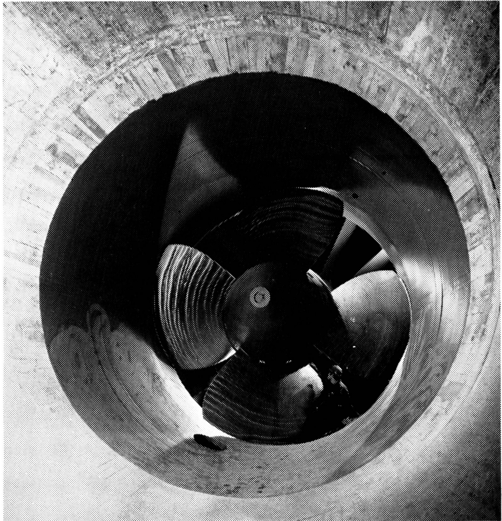
Eine der drei Rohrturbinen in der Anlage Neu Bannwil / Schweiz.
