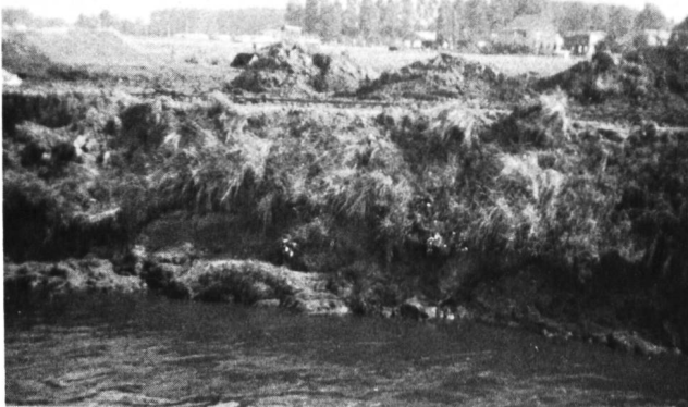
Bild 1. Befestigung eines steilen Flussdammes an der Dyle bei Werchter, Belgien. Das ausgekolkte Flussufer vor der Sanierung.
