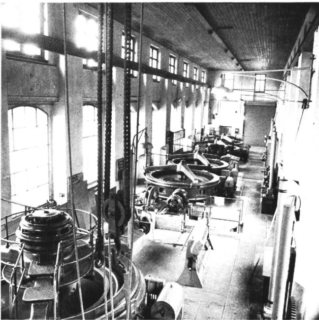
Bild 7. Maschinensaal des 1893–94 erbauten Reusskraftwerks Zufikon. Dieses wurde 1908 erweitert; 1928–31 wurden neue Turbinen eingebaut und die Generatoren umgebaut; 1938–43 wurden die Fundationen am Stauwehr und die Schaltanlage erneuert.
