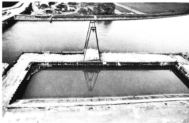
Bild 15. Baustelle des Fangedammes Werkkanal, November 1976. Der Werkkanal verläuft von rechts nach links.
