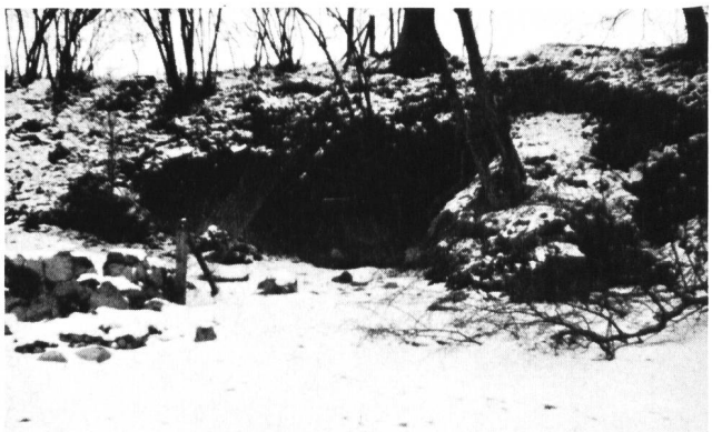
Bild 2. Durch die Rückströmung der auflaufenden Bug- und Heckwellen entsteht eine Absenkungswelle, die als Sog wirkt. Dieser Sog ist massgebend an der Uferzerstörung schuld. Das Bild zeigt eine ausgeschwemmte Rheinufersböschung.
