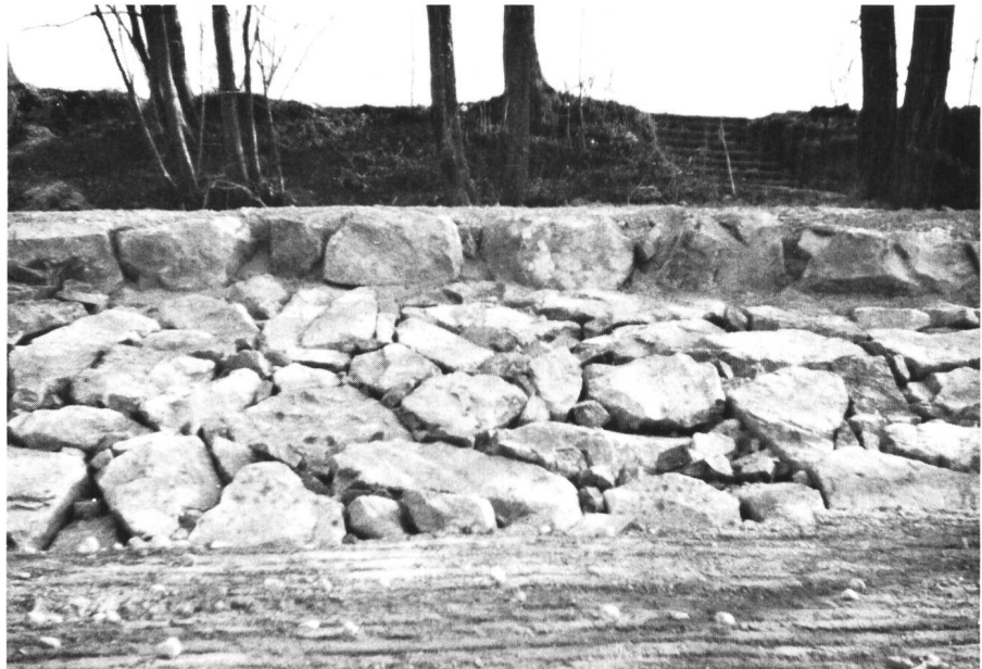
Bild 7. Teststrecke bei Rheinklingen 1976. Die fertige Böschung mit Natursteinen 400 bis 800 kg verkleidet, der obere Abschluss wird von Kopfsteinen, höchstens 1 Tonne schwer, gebildet. Normalprofile Typ A und B.
