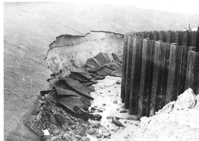
Bild 6. Beschädigte Dachbinnenböschung aus Asphalt nach der Sturmflut 1976.
