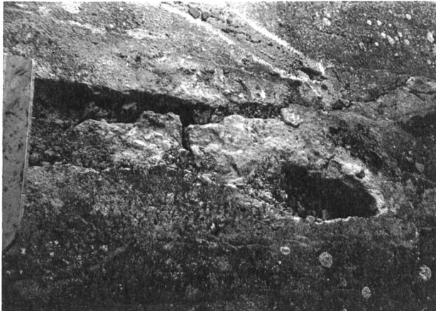
Bild 5. Ein grösserer Schaden an einer Böschungsplatte.
