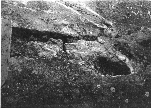
Bild 5. Ein grösserer Schaden an einer Böschungsplatte.
