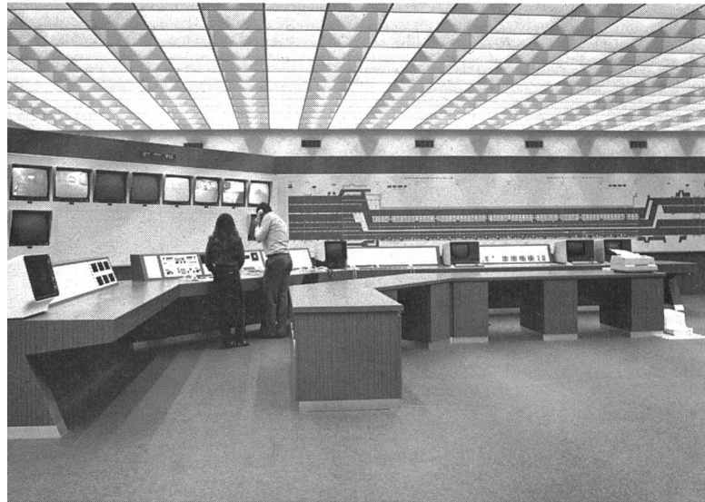
Blick in die Kommandozentrale Göschenen des Gotthard-Strassentunnels, Seite Verkehrsüberwachung durch die Polizei. Rechts schliesst die Betriebsüberwachung für Belüftung, Beleuchtung, Energieversorgung usw. an. In Airolo ist eine analog ausgerüstete Kommandozentrale installiert. Das Kommando wechselt im Turnus von zwei Wochen zwischen den beiden Kommandozentralen Göschenen und Airolo.
