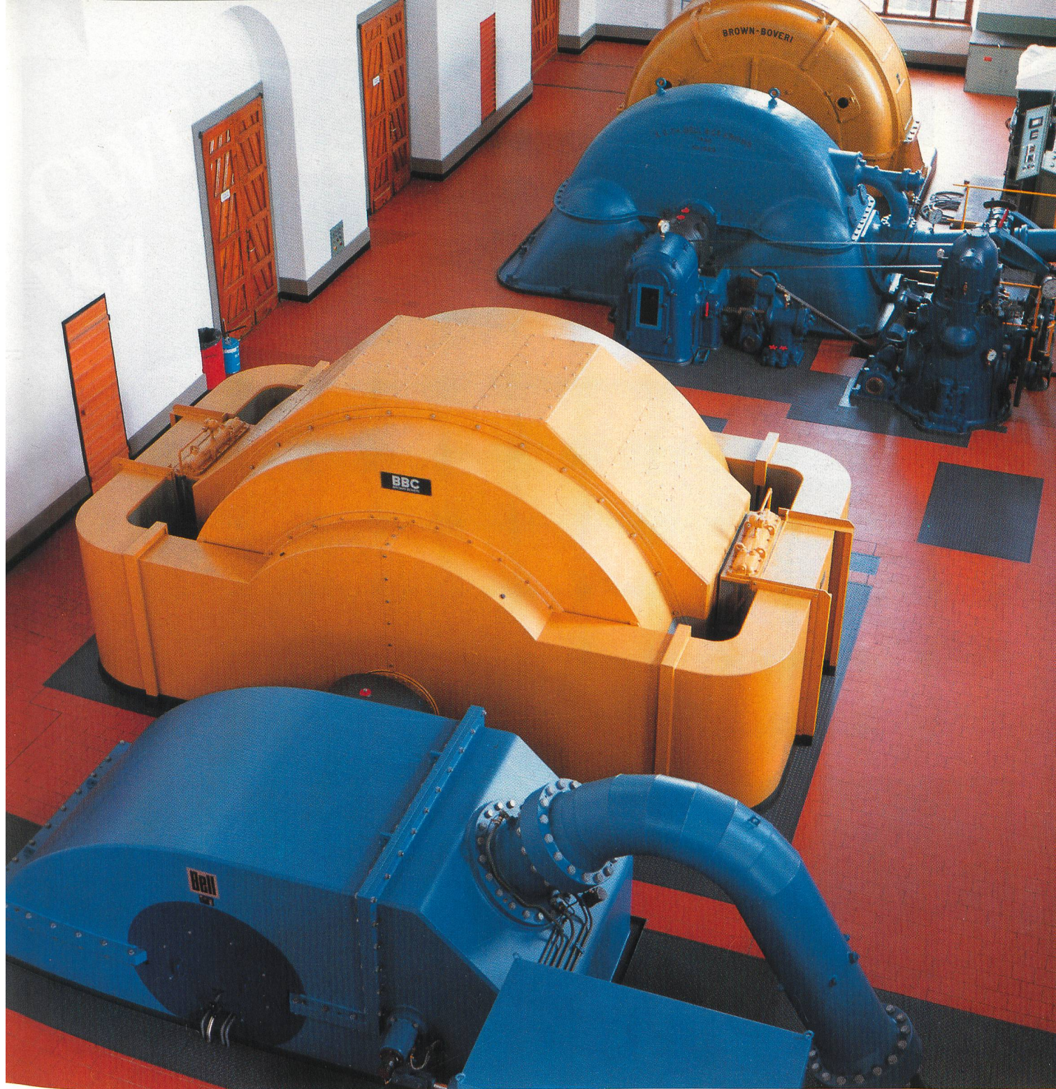
10-MVA-Einphasen-Wasserkraftgenerator für 16 \frac{2}{3} Hz der Bündner Kraftwerke in Klosters. Die neue Maschine wurde anstelle einer alten 10-MVA-Dreiphasenmaschine für 50 Hz eingebaut. Trotz knappster Platzverhältnisse konnte der Einbau des neuen Generators mit dreifacher Typenleistung realisiert werden. Photo Brown Boveri
