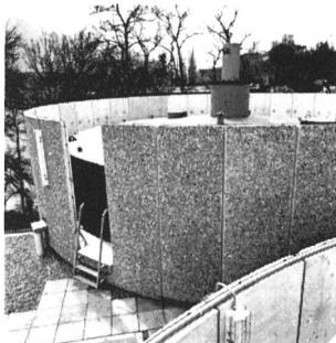
Faulanlage, Villette, Genf
