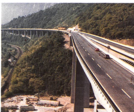
Polyesterbeschichtung auf Viaduktbrüstungen
