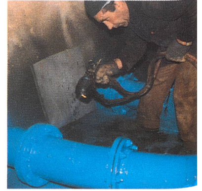
Beschichtung von Leitungen mit Kondenswasser
