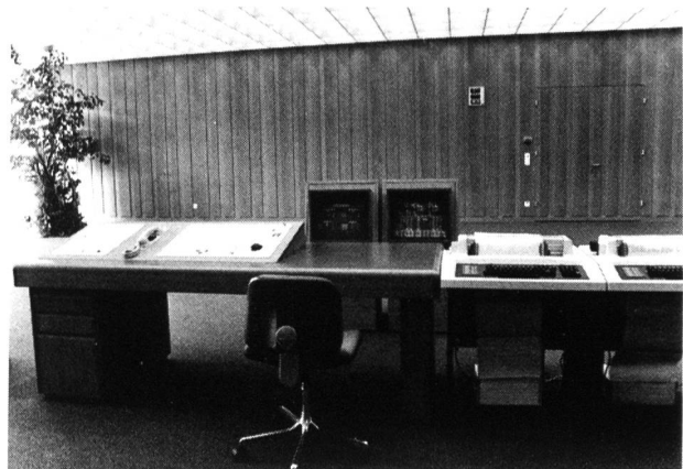
Zentrale einer Netzleitstelle mit Telegyr LS2000.
