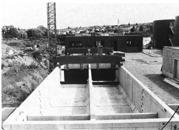
Bild 3. Die neuen Vorklärbecken der Abwasserreinigungsanlage Rietwiesen. Dahinter der Sandfang und das Maschinenhaus.
