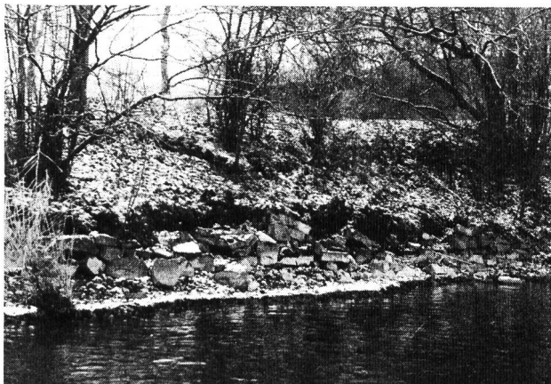
Bild 5. Uferpartie oberhalb Paradies. Die Wellen haben das feinkörnige Unterlagsmaterial aus dem Blocksatz herausgespült, so dass dieser zerfällt. Links ein Überrest des früheren Schilfgürtels.
