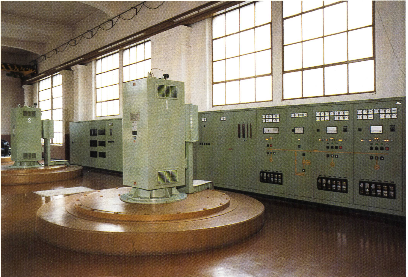
Synchrongenerator 710 kVA, 525 V, 1500 U/min und Getriebe 170/1500 U/min, angetrieben mit Kaplan turbine
