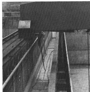
Räumer mit Klärbecken ARA Zofingen
