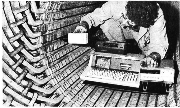
Figure 5. Le bobinage statorique vibre à la fréquence double du réseau lorsque le blocage mécanique dans les encoches est insuffisant. Ceci à pour conséquence une dégradation de l'isolation. Pour cette raison un contrôle de calage du bobinage à intervalles réguliers s'impose. Une nouvelle méthode, basée sur une mesure spéciale des vibrations, permet de réaliser ce contrôle de manière fiable, l'influence de l'opérateur étant éliminée. (Photo BBC Brown Boveri)
