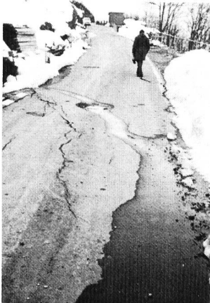
Figure 8. Fissures dans la couverture d'une route.
