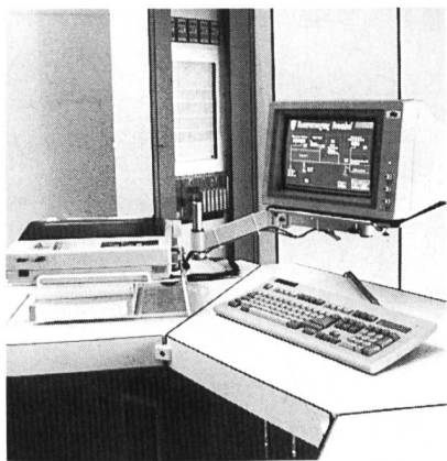
Bild 2. Moderne Steuerung und Betriebsdarstellung mit Prozessvideotechnik.
