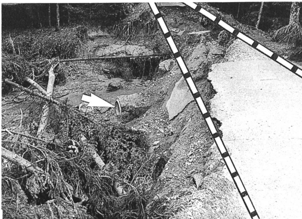
Bild 1. Kleine Ursache – grosse Wirkung: Durch Verstopfen eines Bachdurchlasses erfolgte ein Aufstau und anschliessend ein Überfließen des Strassendamms. Dadurch wurde die unterwasserseitige Böschung erodiert, was zur vollständigen Zerstörung von Damm und Strasse führte. In Bildmitte (Pfeil) ist das Ende des teilweise freigelegten Rohrdurchlasses zu erkennen. Die gestrichelten Linien rechts im Bild veranschaulichen das ursprüngliche Strassentrassée. Aufnahme in Willisau-Land nach dem Unwetter vom 16. Juni 1988. (Foto: Foto-Kino Schaller, Willisau)
