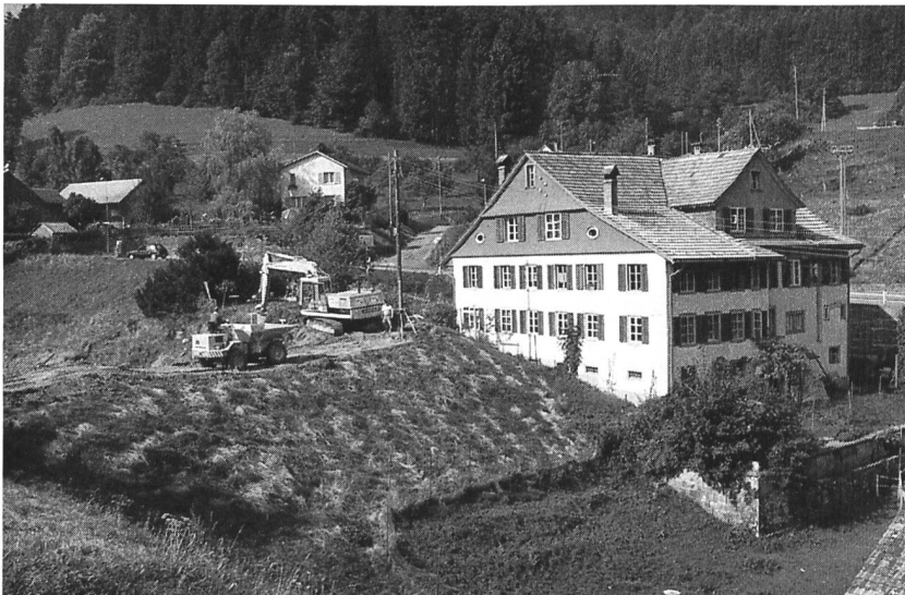
Bild 1. Damm Unterer Weiher mit ehemaliger Mühle Muetsbach – Ansicht von unten. Die Baumaschinen im Bilde sind mit dem Abtrag der Dammkrone beschäftigt. Zusammen mit der neuen Hochwasserentlastung und weiteren baulichen Massnahmen wird damit die Gewähr für die geforderte Sicherheit gegeben sein.
