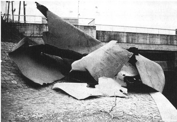
Bild 6. Teil der herausgerissenen und aus dem Unterwasser geborgenen Tosbeckenpanzerung.
