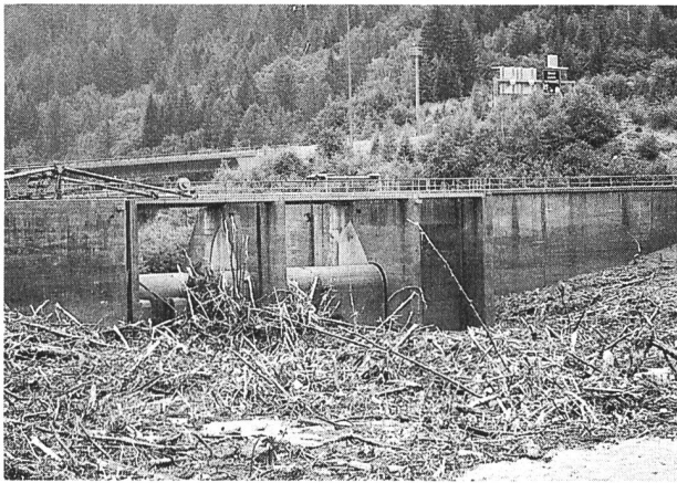
Bild 4. Schwemmholz vor den Klappen der Hochwasserentlastung.
