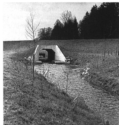
Bild 10. Auslaufbauwerk des Ableitkanals mit Tosbecken.
