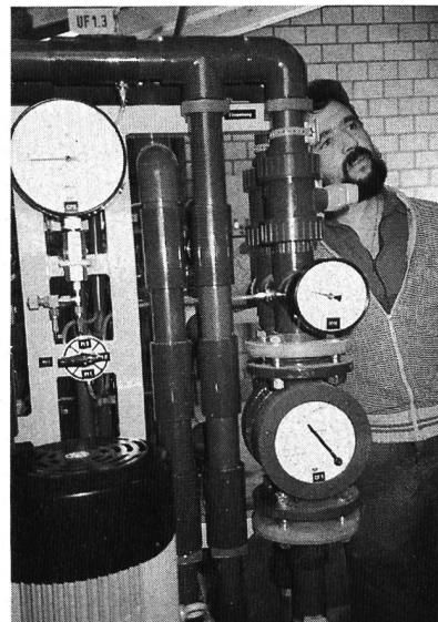
Bild 2. Druckeinrichtungen der Ultrafiltrationsanlage.
