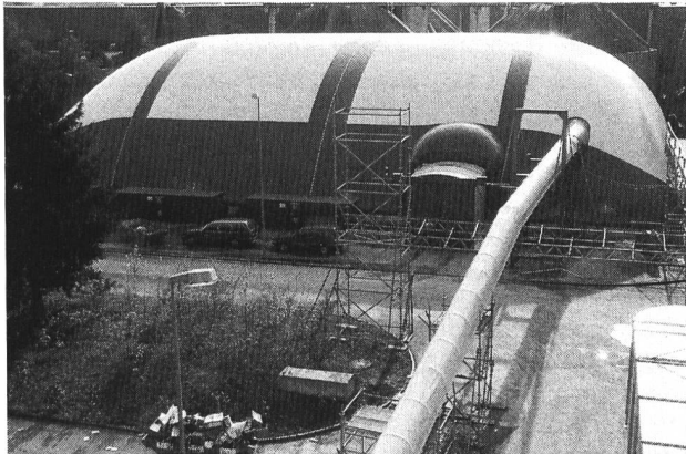
Bild 2. Die Traglufthalle für die Klärschlamm-Entgasung mit dem Förderband zum Transport des entwässerten Schlammes von der Entwässerungsanlage in die Halle.
