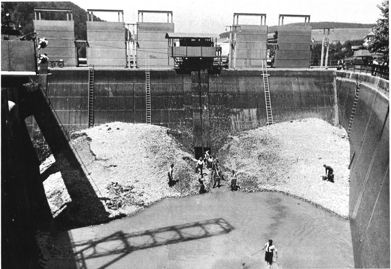
Bild 10–5. Feinrechen vor dem Turbineneinlauf. Zwischen den beiden Haufen angeschwemmten Gerölls wurde ein Einschnitt ausgeräumt, um das Wasser ableiten zu können. Zustand vor dem Umbau 1978.
