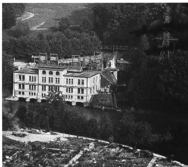
Bild 14–4. Die alte Zentrale Felsenau während des Umbaus. Rechts ist die Baugrube für das neue Maschinenhaus zu erkennen.
