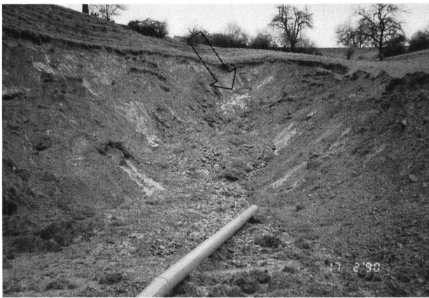
Bild 4. Der klüftige Molassefels (Pfeil) führte zu einer kritischen Vernässung des Deckschichtmaterials von unten.
