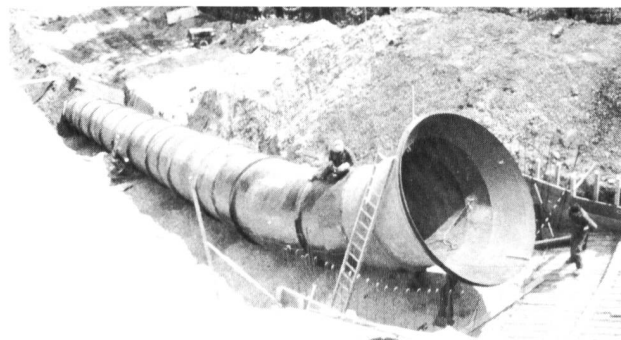
St-Suplice - NE. Forces Motrices Neuchâteloises. Conduite forcée DN 2000
